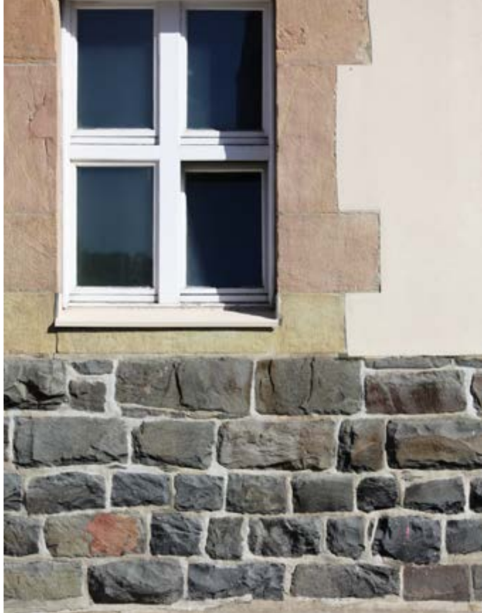
Abbildung 7: TU-Gebäude in Clausthal (1906) mit Grauwacke-Quadern im Sockel und darüber Fenstergewänden aus Hillssandstein. (Foto: U. Schönitz)
