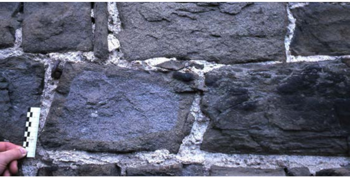
Abbildung 6: Oberflächenschäden und -verluste durch Verwitterung an Grauwacken der Kirchenruine Nordhusen. (Foto: H. Siedel)
